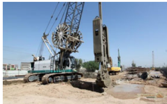
شکل شماره ۱۹- نمایی از دستگاه هیدروفورز مستقر در محدوده‌ی ایستگاه پردیس اهواز
