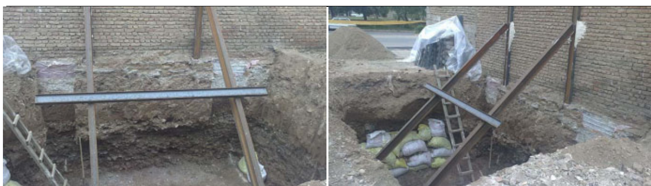
تصویر شماره (۲): اجرای غیر اصولی سازه نگهدارنده و سیستم نگهدارنده
